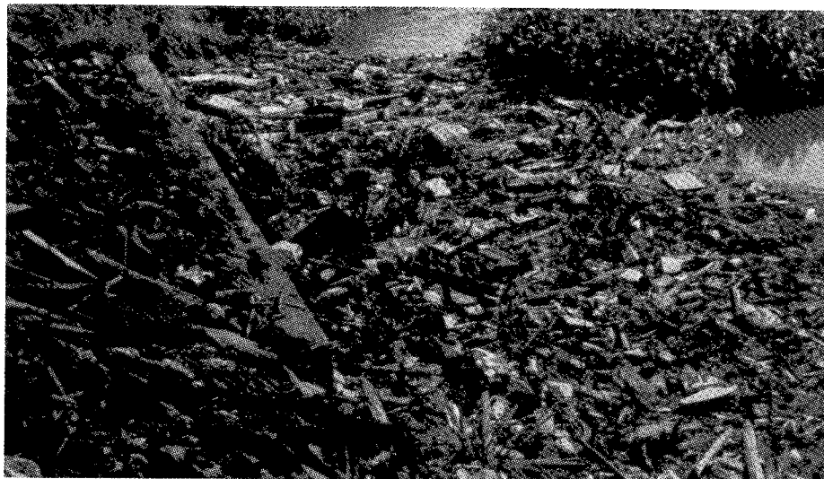
Foto 4 - Bueiro no igarapé do Quarenta, mostrando o acúmulo de lixo.
